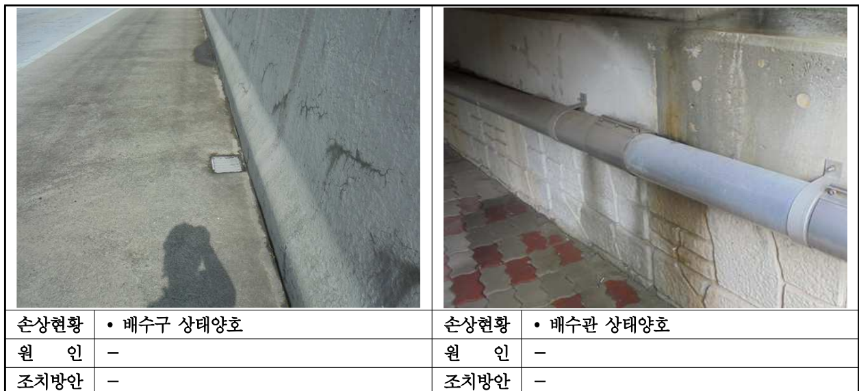
【사진 27.3.20】 배수시설 손상현황
