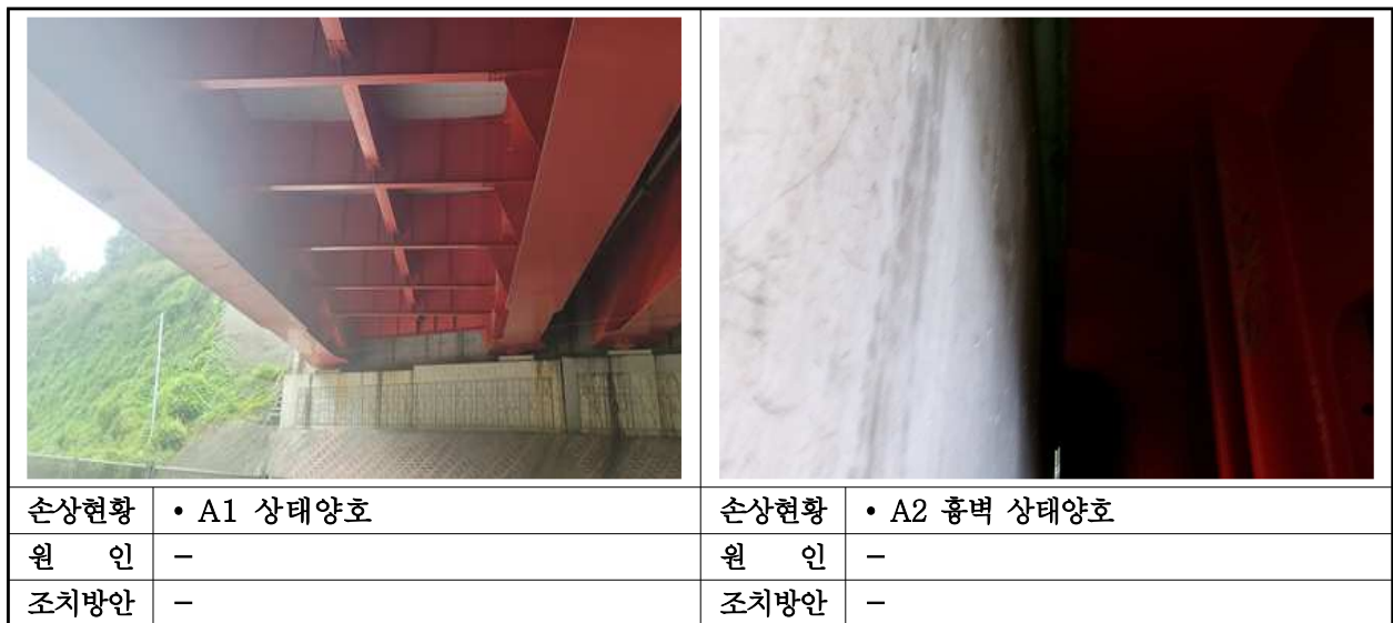
【사진 27.3.9】 교대 손상현황
